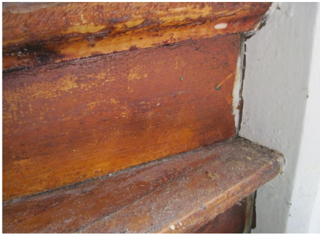
Limrester i trappa efter heltäckningsmatta
